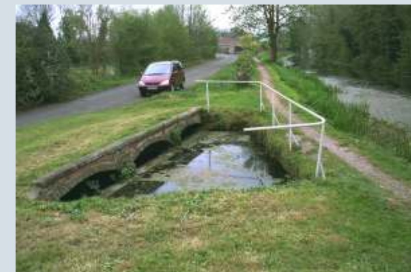
Newton Lock Spill Weir
